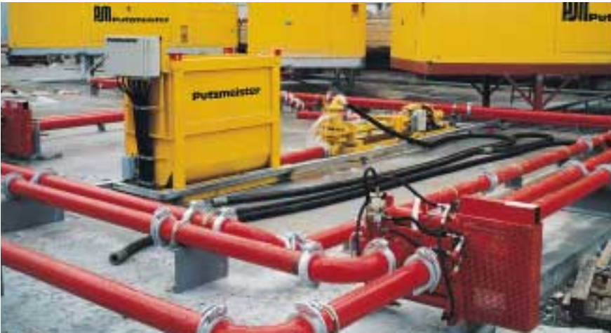
Mediante corredera y desvíos se pueden tender con facilidad sistemas de tuberías de transporte complejos con tuberías de transporte de PM. Aquí, sistema de distribución SK en Oeresund, Dinamarca
